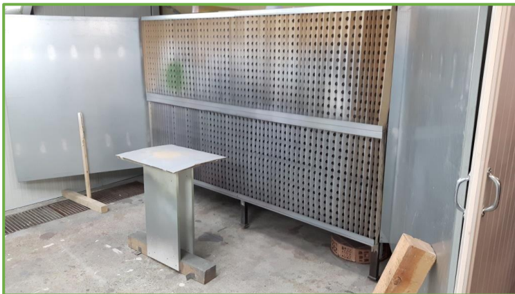
Lackierkabine mit Farbnebelabsaugwand
