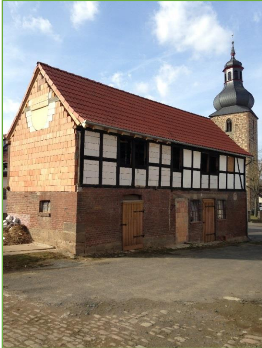
Das Fachwerkgebäude (früherer Pferdestall) vor und während des Umbaus. © Fotografien Christiana Schmidt
